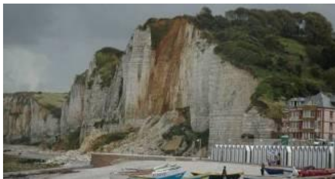
Erosion à Yport
