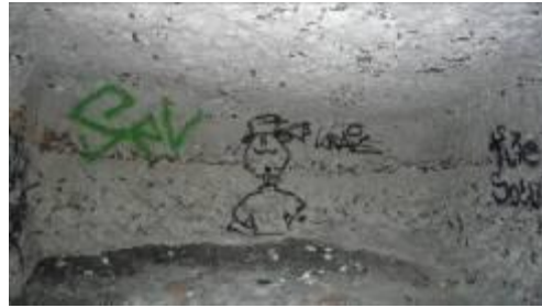
Valleuse de Bruneval fréquentée (déchets et dégradations)
